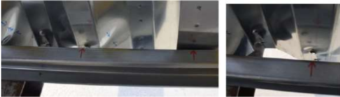
Figura 22: Cedarea punctelor de sudură dintre inimă și talpă – grinda CWB SW-2.
